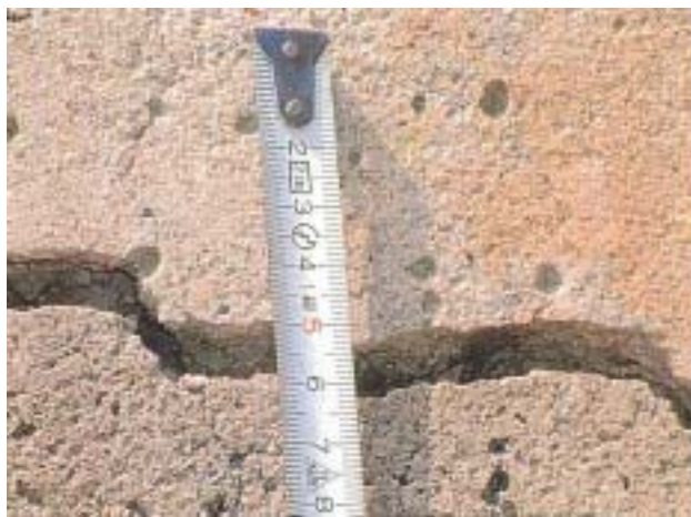
写真 - 2 ひび割幅実測状況
