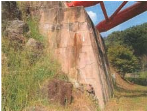
写真 - 1 ひび割れの状況
