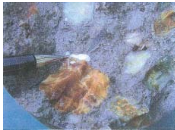
写真 - 4 アルカリシリカゲル発生状況
